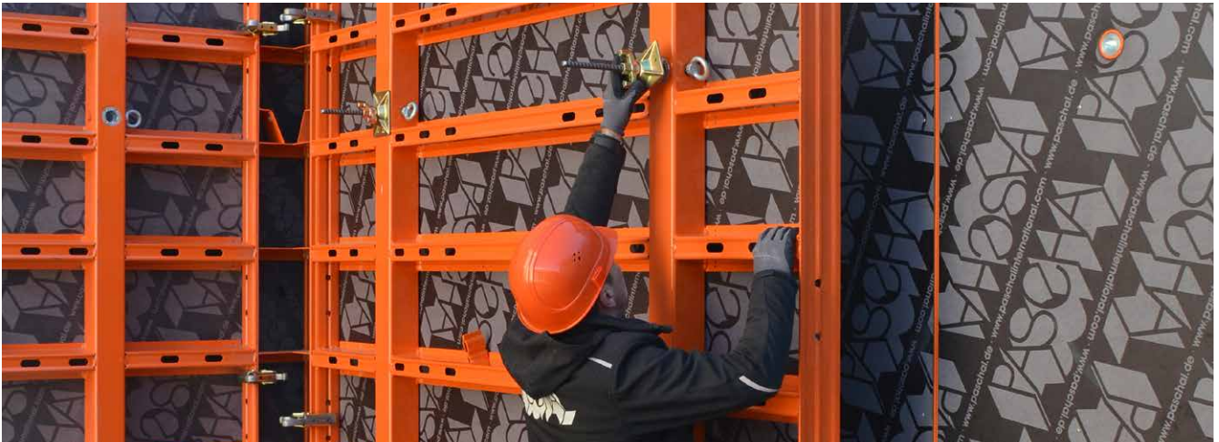
Die einseitige Ankerstechnik ermöglicht die Bedienung der Schalungsanker mit nur einer Person.
